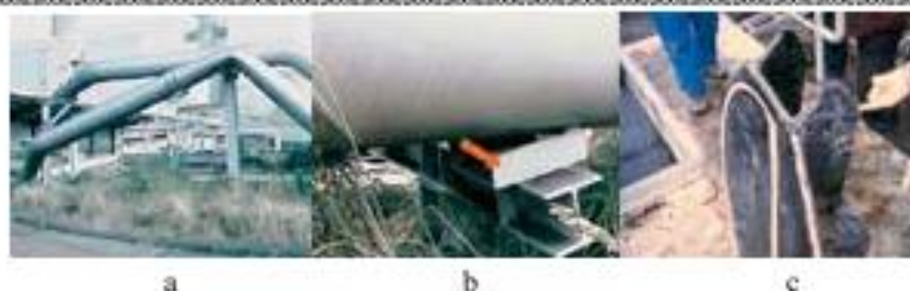
Рисунок 1 - а- Полностью разрушенная напорная труба DN 600 (толщина стенок 12 мм), б-Разрушенный суппорт (двутавровый профиль 200 мм окончательно деформирован), с- Обратный клапан DN 800 после скачка давления в напорной трубе.
